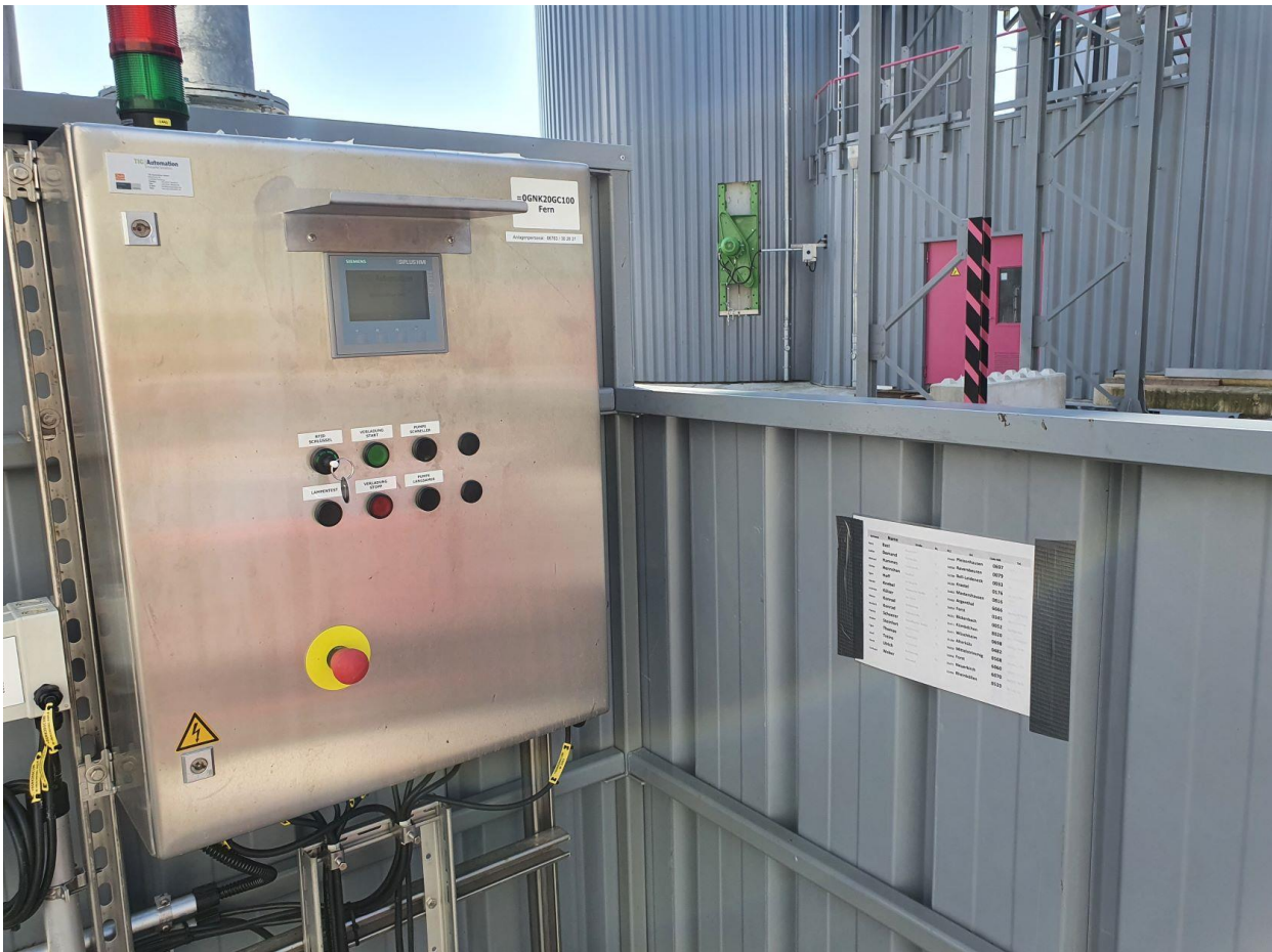
Abb. 8: Terminal zur Steuerung der automatisierten Befüllung von Transportern mit Gärprodukt und digitaler Dokumentation dieser Befüllung
